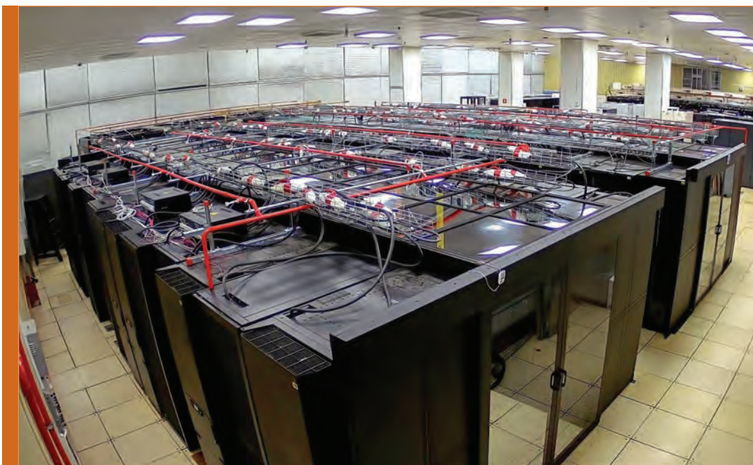
Вид сверху на модернизированные модули 1 и 2, переведенные на охлаждение холодного коридора межрядными кондиционерами, в машинном зале МИВК
